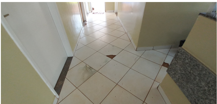
Foto 3 - Pisos quebrados ou faltosos, em processo de manutenção.
