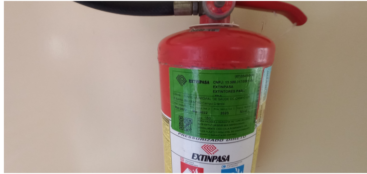
Foto 4 - Extintores com a data de validade expirada.
