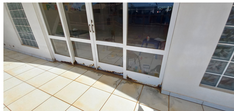
Foto 8 - Portas corroídas pela ferrugem.
