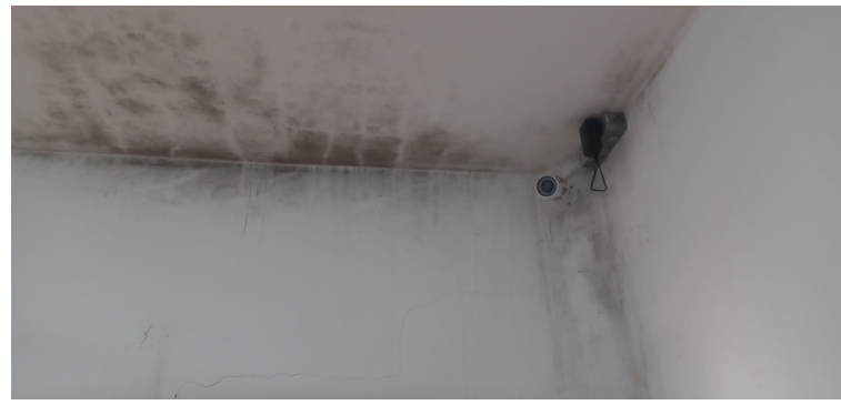
Foto 2 - Paredes com pintura desgastada, infiltrações e bolor evidente.
