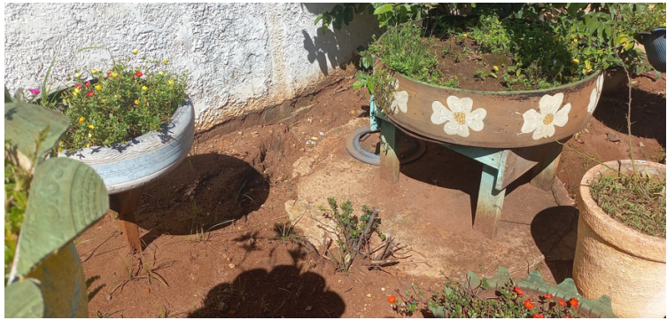
Foto 5 - Fossa com erosão comprometendo a estrutura da unidade.
