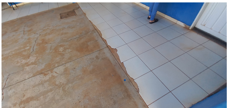
Foto 7 - Assoalho com azulejos quebrados.
