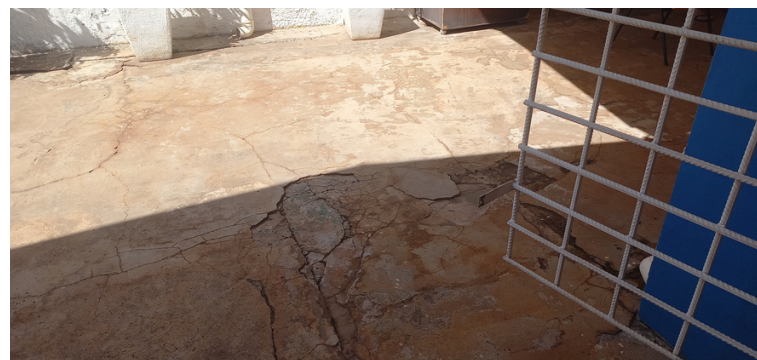
Foto 8 - Pavimento com muitos desníveis.
