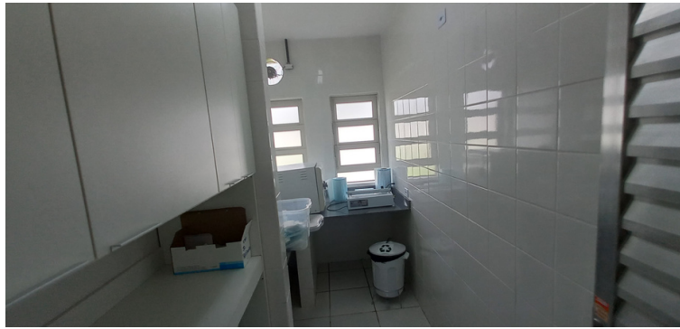
Foto 3 - Autoclave da unidade aguardando reparo.
