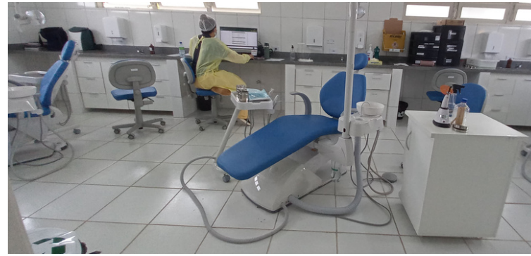
Foto 4 - Cadeira do setor de Odontologia apresentando vazamento.
