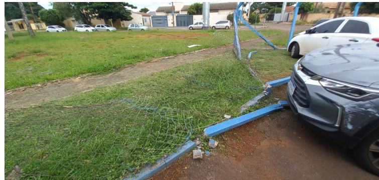
Foto 12 - Parte da grade que circunda a unidade, está danificada.
