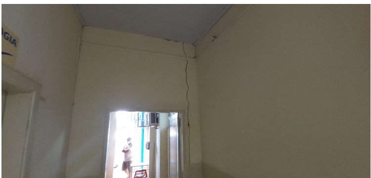
Foto 7 - Rachaduras prejudicando a estrutura da Ubs.
