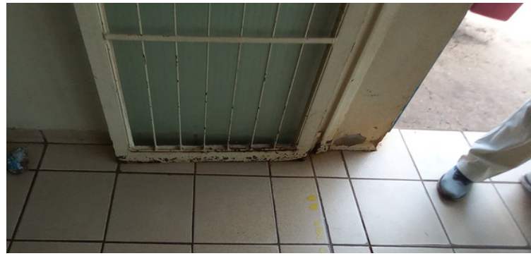
Foto 10 - Portas e esquadrias corroídas pelo mofo.
