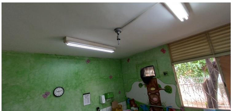
Foto 7 - Salas sem a devida climatização.
