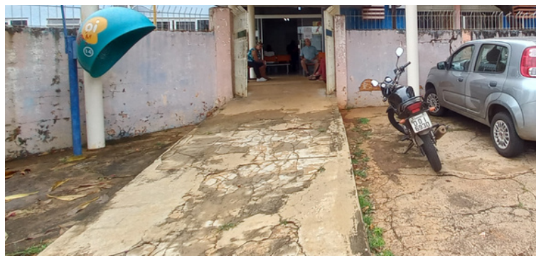
Foto 12 - Unidade sem acessibilidade adequada.
