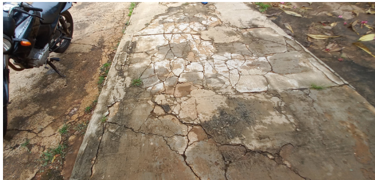
Foto 11 - Pavimento de acesso à unidade com desníveis.
