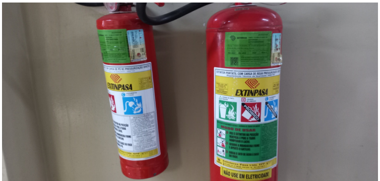
Foto 6 - Extintores da unidade com data expirada.
