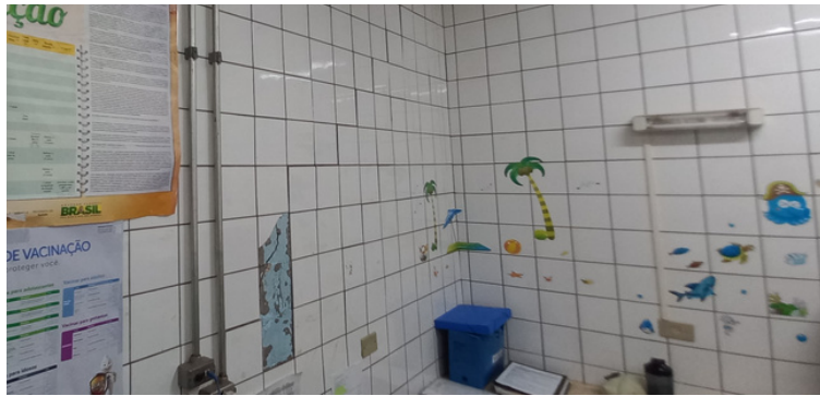
Foto 3 - Salas com azulejos caídos.
