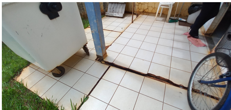
Foto 13 - Extensas rachaduras comprometendo a edificação da unidade.
