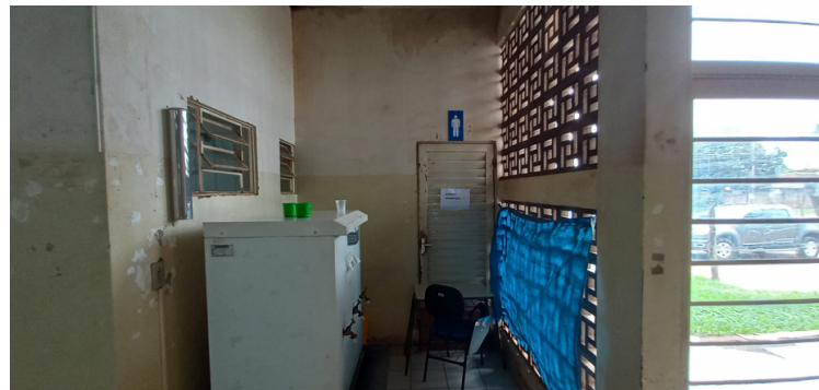
Foto 4 - Banheiro feminino interditado.
