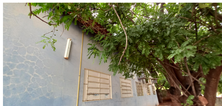
Foto 14 - Galhos de árvores atingindo o telhado, danificando sua estrutura.
