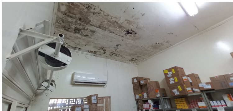
Foto 5 - Farmácia repleta de mofo, comprometendo a conservação de medicamentos.
