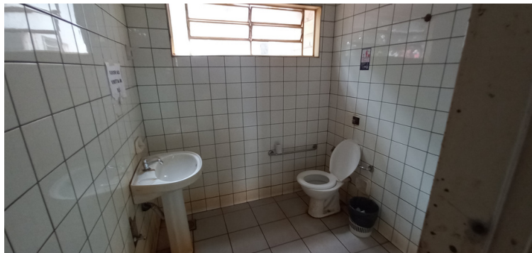
Foto 3 - Banheiro masculino desprovido de manutenção e consideravelmente mofado.
