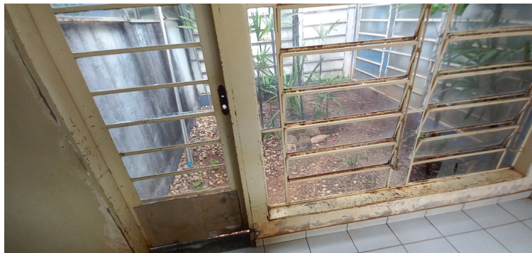
Foto 11 - Portas e esquadrias corroídas pela ferrugem.
