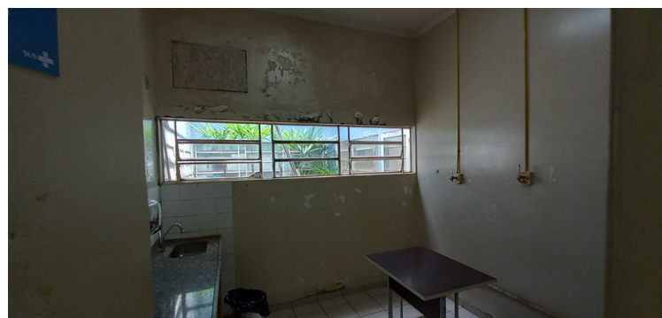
Foto 6 - Sala de inalação interditada devido aa alto teor de insalubridade.
