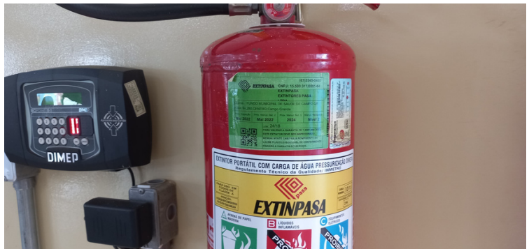
Foto 6 - Extintores da unidade com data expirada.
