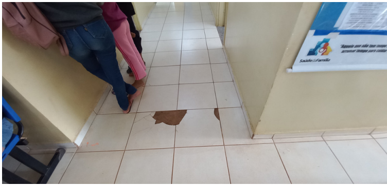
Foto 9 - Assoalho com azulejos quebrados.
