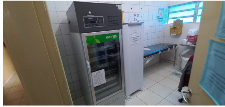
Foto 4 - Câmara fria da sala de vacinas avariada.
