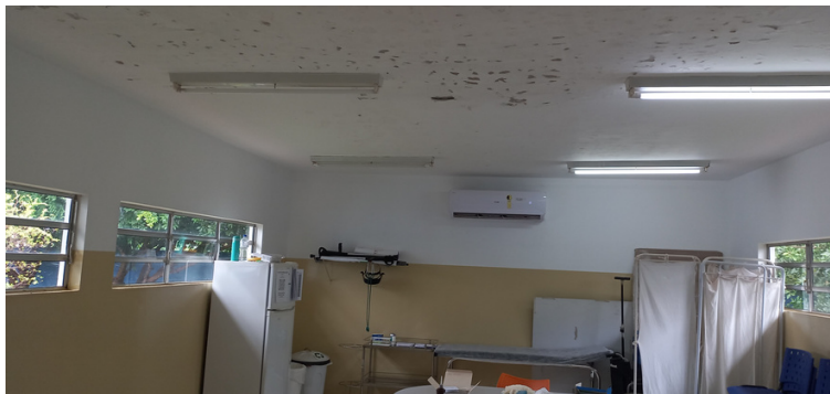
Foto 5 - Auditório com pontos de infiltração e bolor evidente.
