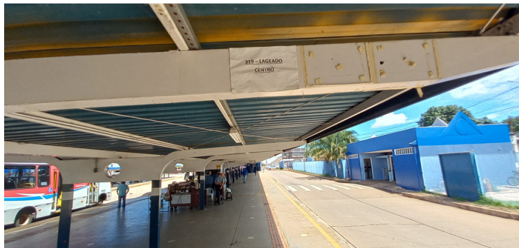
Foto 5 - Sinalização inadequada das linhas de ônibus.
