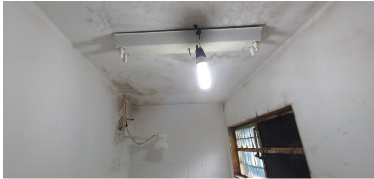
Foto 3 - Fiação elétrica exposta.
