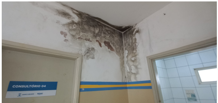
Foto 6 - Vários pontos de infiltração e mofo evidente.
