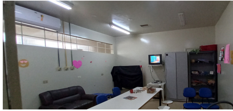
Foto 4 - Luminárias com lâmpadas queimadas.
