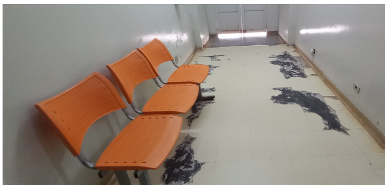
Foto 7 - Piso da unidade extremamente deteriorado.
