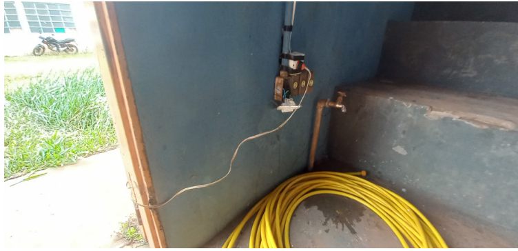
Foto 11 - Fiação exposta na quadra de esportes.
