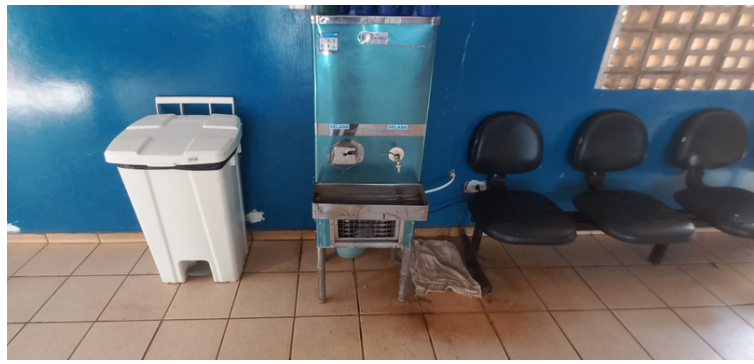
Foto 12 - Bebedouro da repartição avariado.
