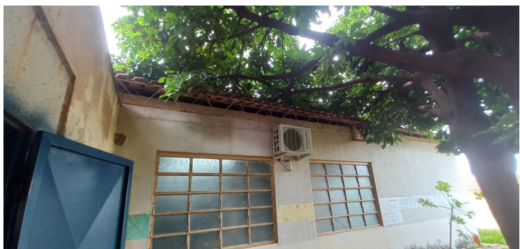
Foto 7 - Árvores em poda adequada, comprometendo o telhado.
