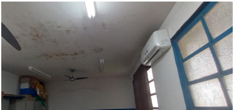
Foto 6 - Lâmpadas queimadas carecendo troca.
