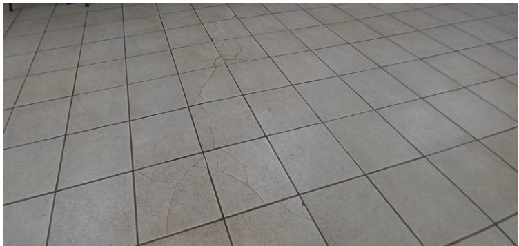
Foto 5 - Piso quebrado aguardando reparo.
