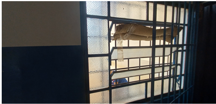
Foto 3 - Vidros quebrados tentando substituição.
