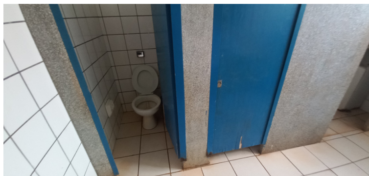
Foto 8 - Banheiros com portas danificadas e sem fechaduras.
