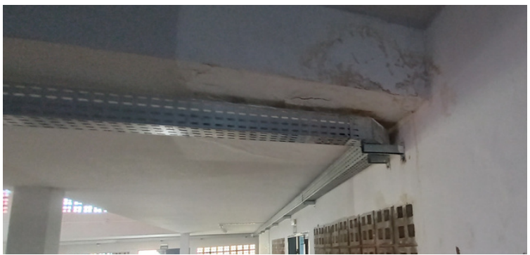
Foto 4 - Pintura desgastada, com infiltração e bolor aparente.
