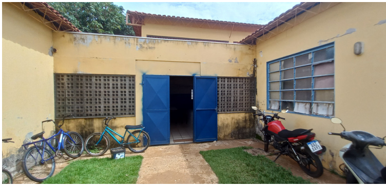
Foto 9 - Pintura externa necessitando revitalização.
