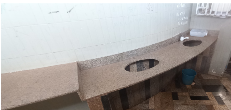
Foto 4 - Sanitários desprovidos de torneiras e pias.
