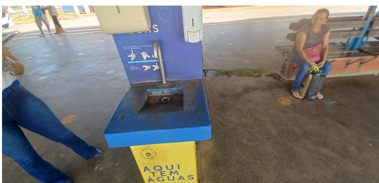
Foto 7 - Lavatório danificado, sem funcionalidade.
