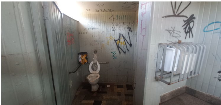
Foto 3 - Banheiros sem iluminação, inóspitos e repleto de pichações.
