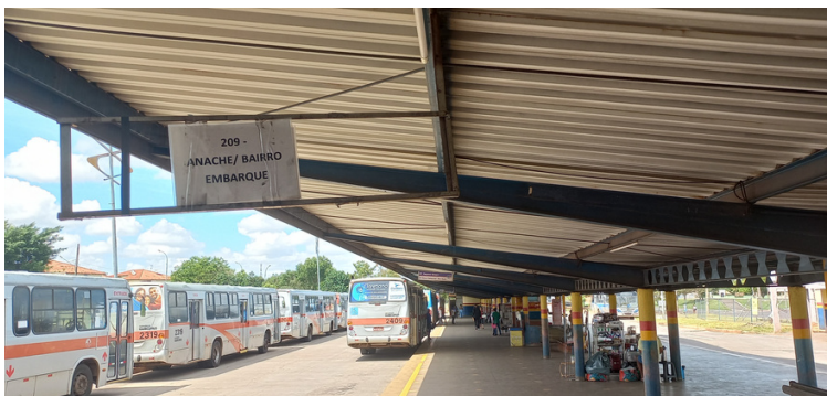
Foto 5 - Sinalização inadequada das linhas de ônibus.
