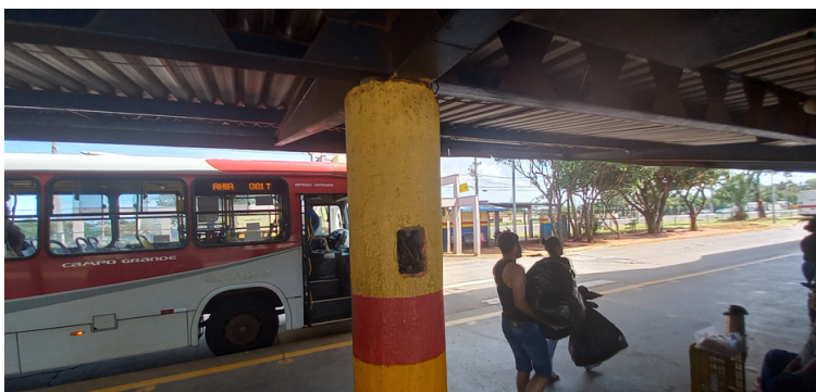
Foto 8 - Fiação elétrica exposta, oportunizando furtos e avarias.
