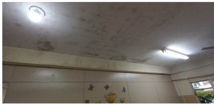
Foto 2 - Infiltrações e proliferação de mofo ocorrem em determinados locais do centro.
