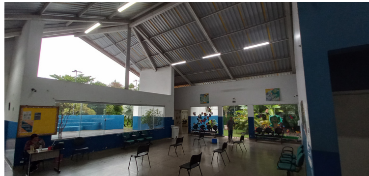
Foto 4 - Rede elétrica defasada, acarretando em oscilação na iluminação e queima recorrente de lâmpadas.
