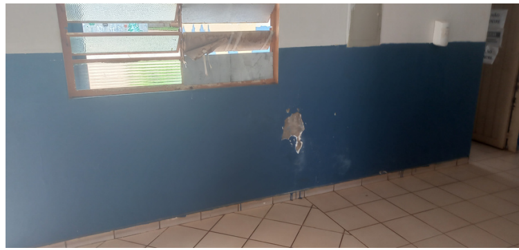
Foto 2 - Vidros quebrados aguardando a substituição.
