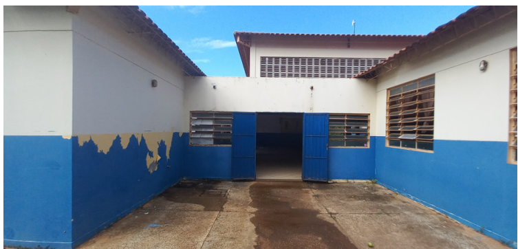
Foto 7 - Pintura externa desgastada.
