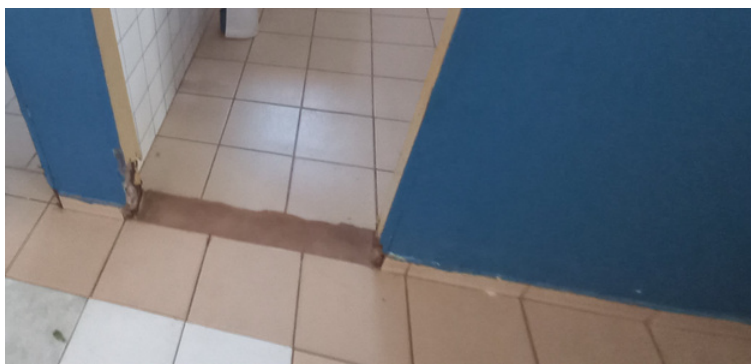
Foto 6 - Banheiro sem porta.
