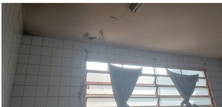
Foto 4 - Pintura desgastada carecendo revitalização.
