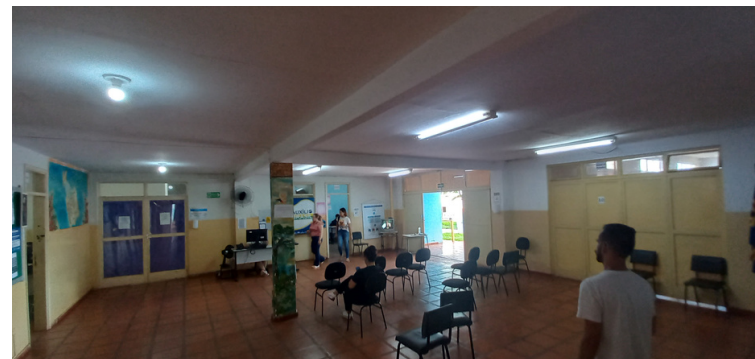
Foto 6 - Recepção sem a devida climatização.
