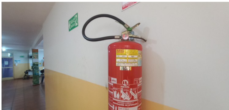
Foto 12 - Extintores com a data de validade vencida.
