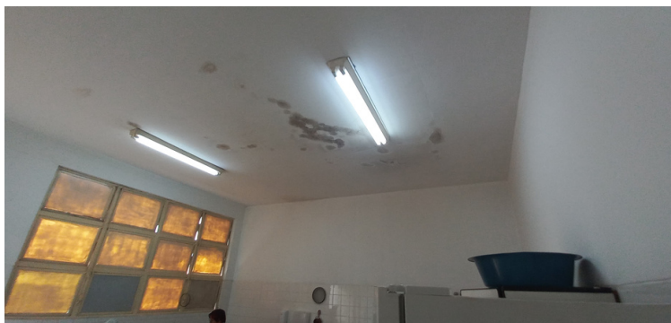
Foto 10 - Infiltrações e proliferação de mofo ocorrem na cozinha.
