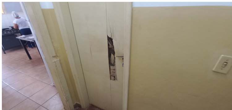
Foto 11 - Portas desgastadas e deterioradas.
