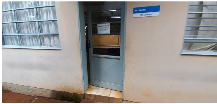
Foto 2 - Vidros quebrados aguardando substituição.
