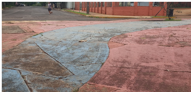
Foto 2 - Calçamento interno da praça com rachaduras.
