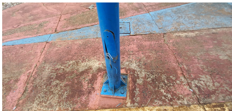
Foto 6 - Postes de iluminação com a fiação danificada.
