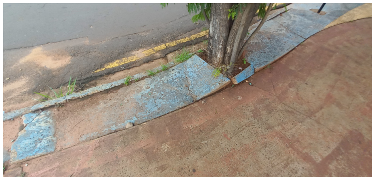
Foto 3 - Raízes de árvores prejudicando a estrutura da calçada.
