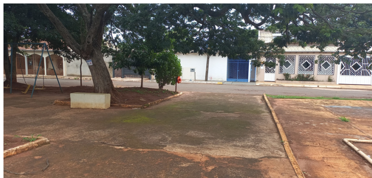
Foto 2 - Calçamento da praça com rachaduras.
