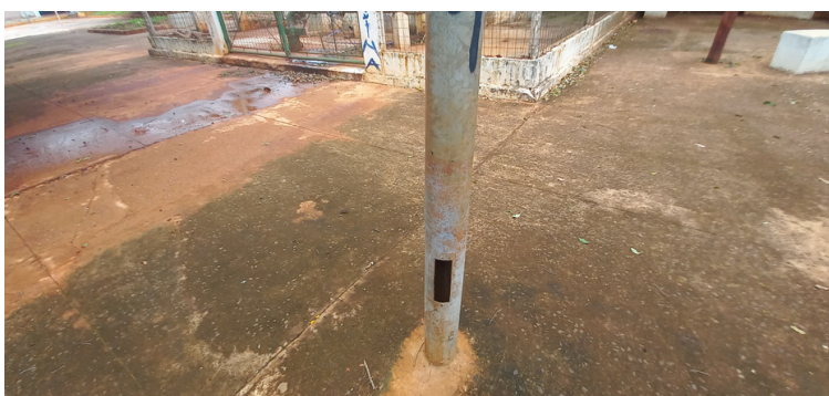
Foto 7 - Postes de luz isentos de fiação elétrica.
