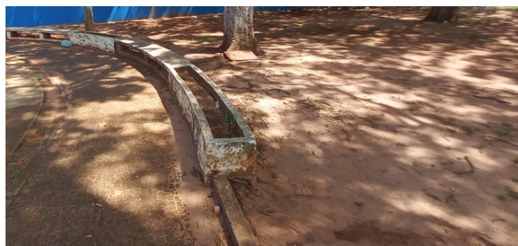
Foto 7 - Bancos de descanso danificados.
