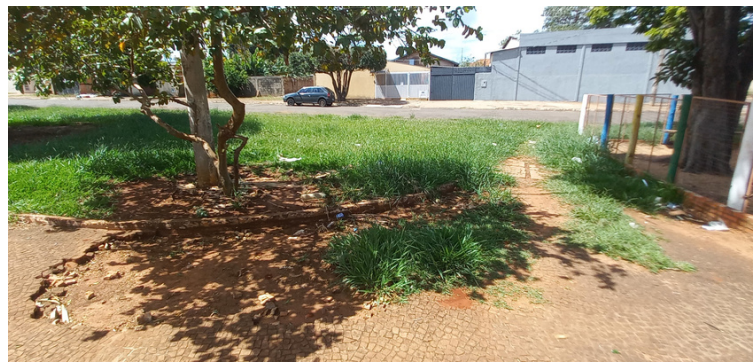
Foto 5 - Calçada desnivelada em vários pontos.
