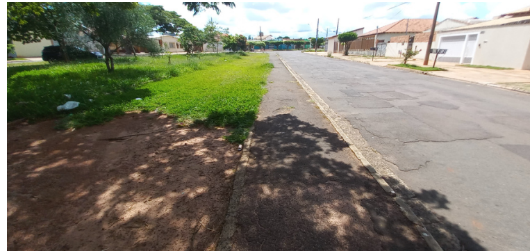
Foto 4 - Pista com desníveis e pavimento desgastado.
