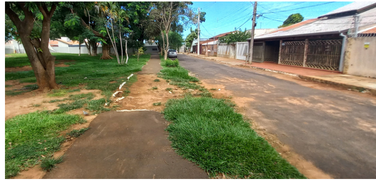
Foto 4 - Determinado ponto da pista de caminhada deteriorado.
