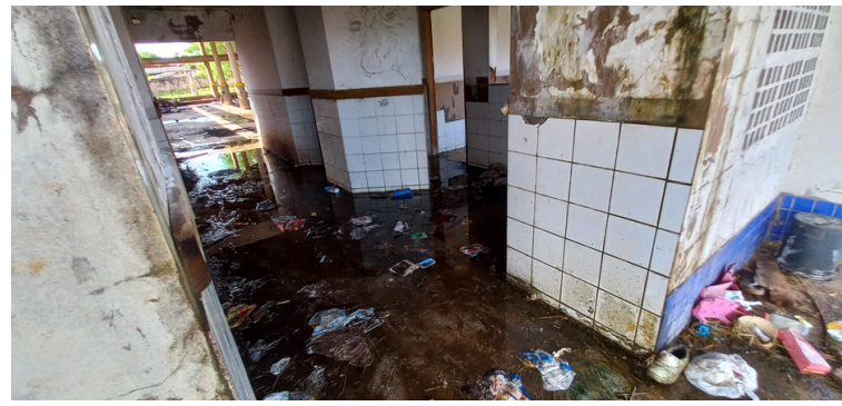
Foto 2 - Lixo acumulado por toda a extensão da construção.
