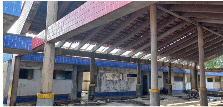
Foto 4 - Telhas quebradas e furtadas.
