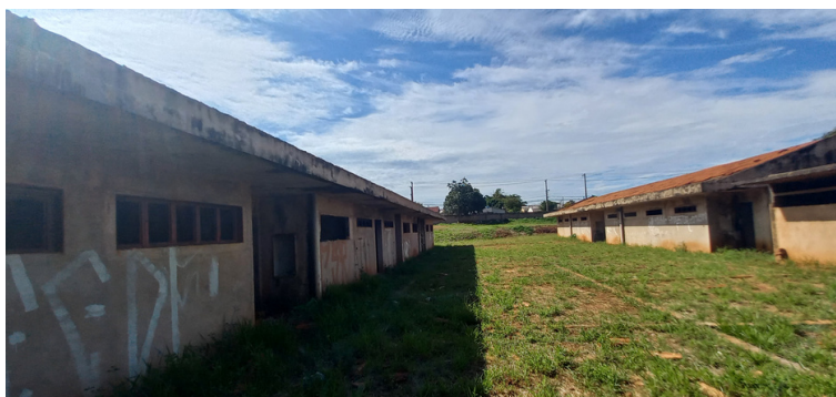
Foto 7 - Obra depreciada pela ação do tempo e pelas intempéries.
