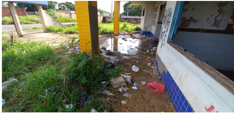
Foto 3 - Acúmulo de água por toda a edificação.
