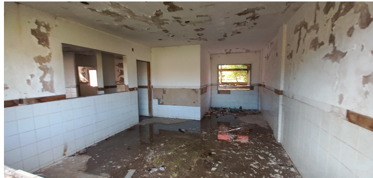
Foto 5 - Pintura bastante desgastada.
