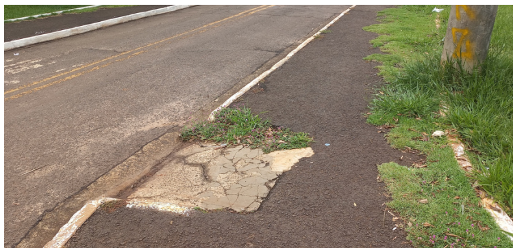
Foto 4 - Pista de caminhada com pontos com desníveis .
