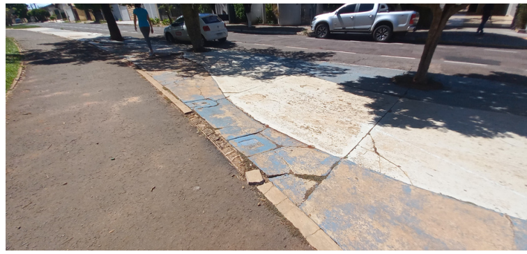
Foto 2 - Pista de caminhada com desniveis no pavimento.
