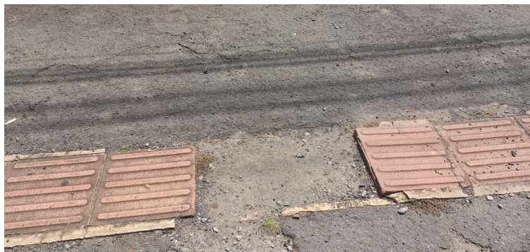
Foto 3 - Piso táctil danificado.
