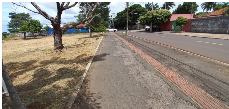
Foto 4 - Pista de caminhada deteriorada.
