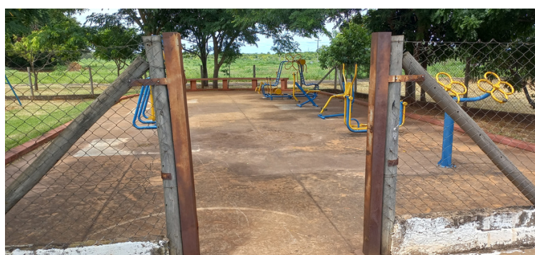
Foto 8 - Portão inexistente na área recreativa.
