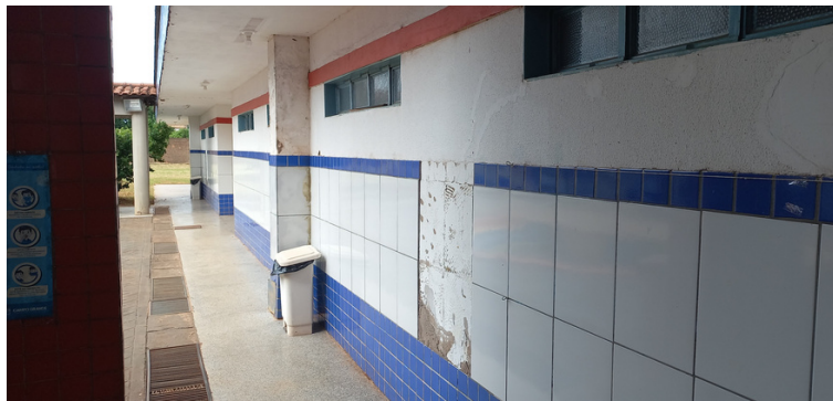
Foto 3 - Locais pontuais com azulejos caídos.
