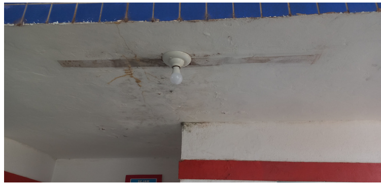
Foto 2 - Teto com infiltração e bolor evidente.
