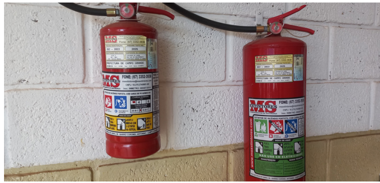
Foto 4 - Extintor de incêndio com data expirada .
