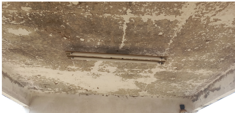
Foto 3 - Pontos localizados de infiltração e mofo evidente no teto.
