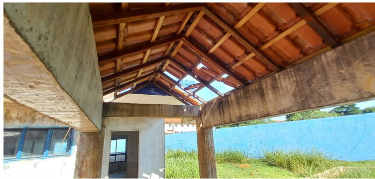
Foto 4 - Telhas quebradas em vários pontos da construção.
