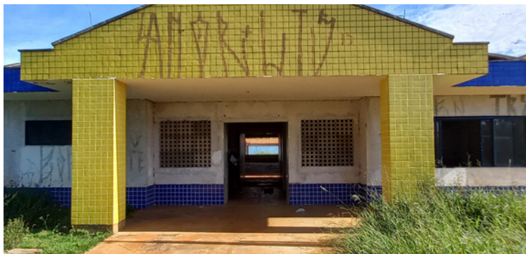
Foto 10 - A construção padeceu com atos de vandalismo.
