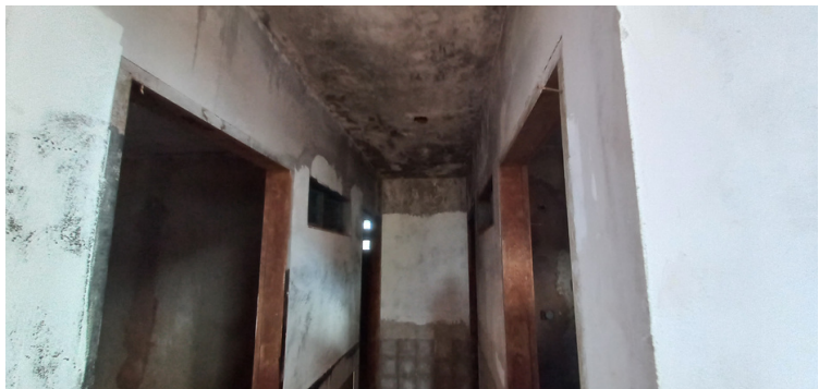
Foto 5 - Pontos com pintura desgastada e bolor evidente.
