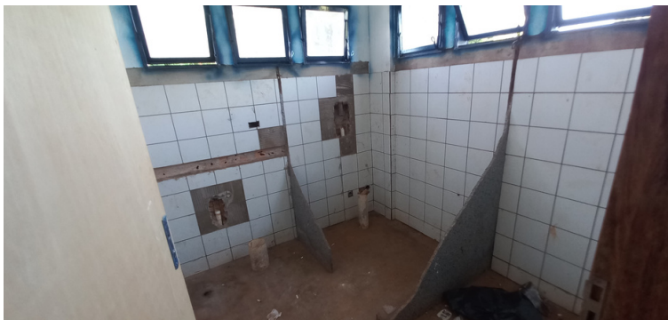
Foto 9 - A obra inacabada sofreu furtos de materiais.
