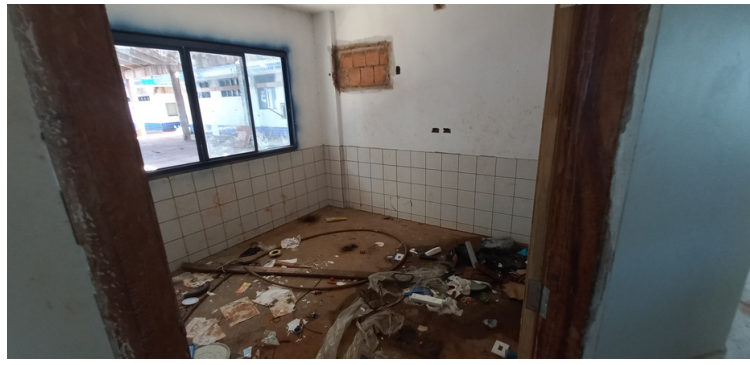
Foto 2 - Lixo acumulado em toda a obra.
