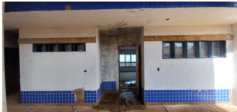
Foto 6 - Locais com infiltração e azulejos caídos.
