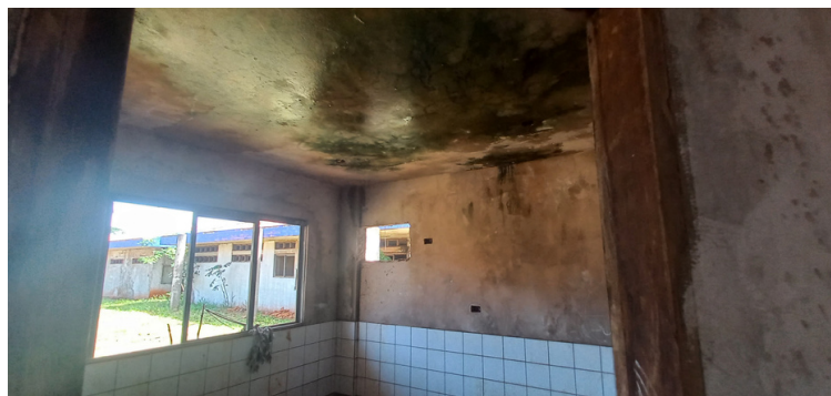
Foto 4 - Infiltrações e mofo comprometendo a edificação.
