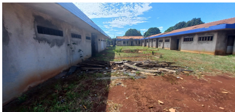
Foto 6 - Entulhos descartados no local.
