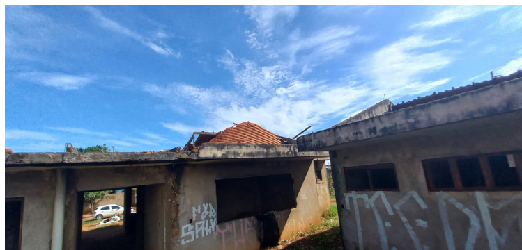
Foto 2 - Telhas avariadas e constantes objetos de furtos.
