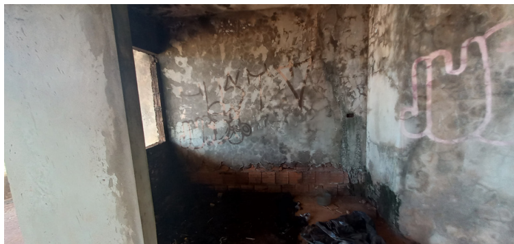
Foto 3 - Infiltrações e mofo comprometendo a edificação.
