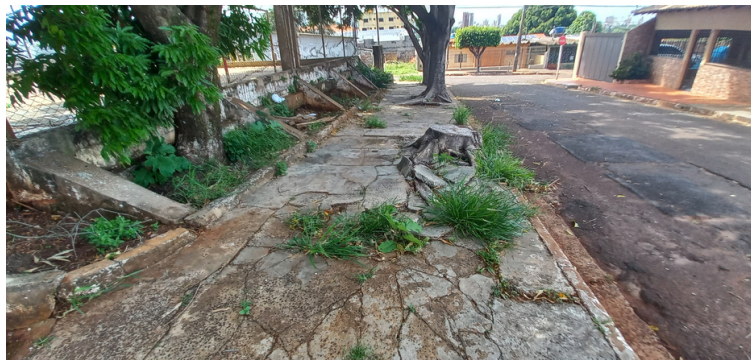
Foto 1 - Calçada danificada por toda a extensão da praça.
