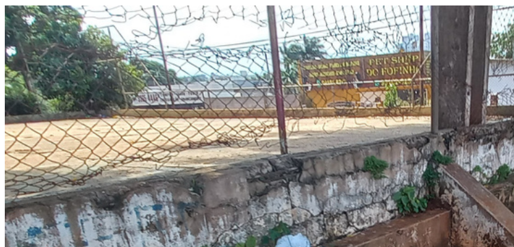
Foto 5 - Tela de proteção da quadra de esportes, danificada.
