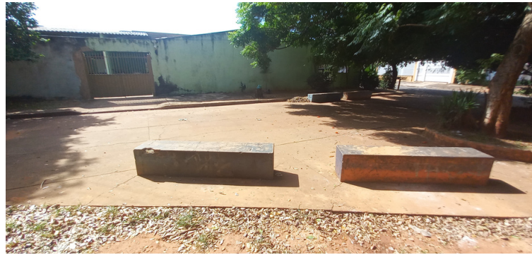
Foto 5 - Determinados bancos deteriorados.
