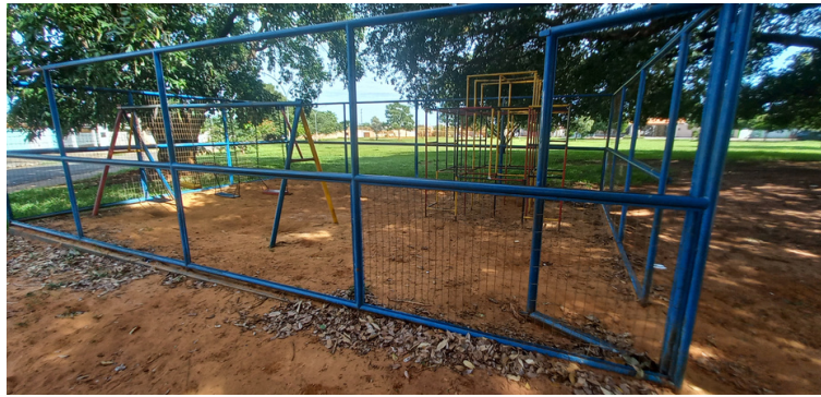
Foto 3 - Parque infantil com tela de proteção danificada.
