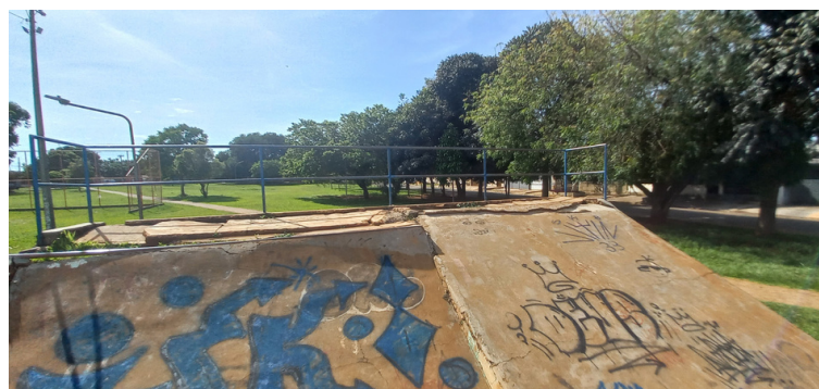
Foto 7 - Pista para a prática de skate vandalizada.
