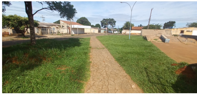
Foto 2 - Calçada com piso irregular e desníveis em vários pontos.
