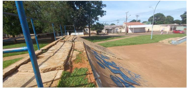
Foto 6 - Pista de skate com rachaduras evidentes.
