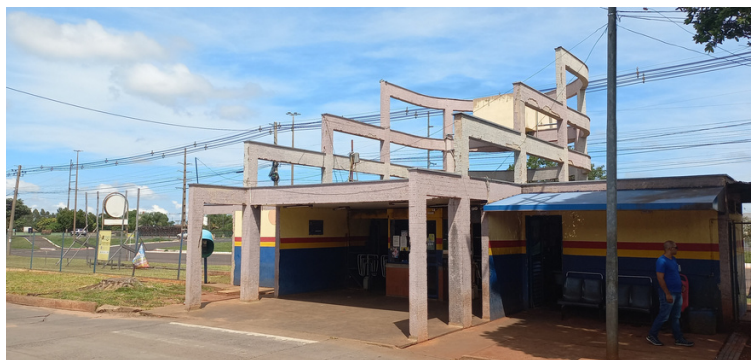
Foto 1 - Fachada do Terminal Nova Bahia desprovido de revestimento.
