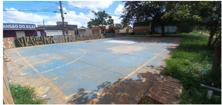
Foto 6 - Quadra poliesportiva com piso desgastado.
