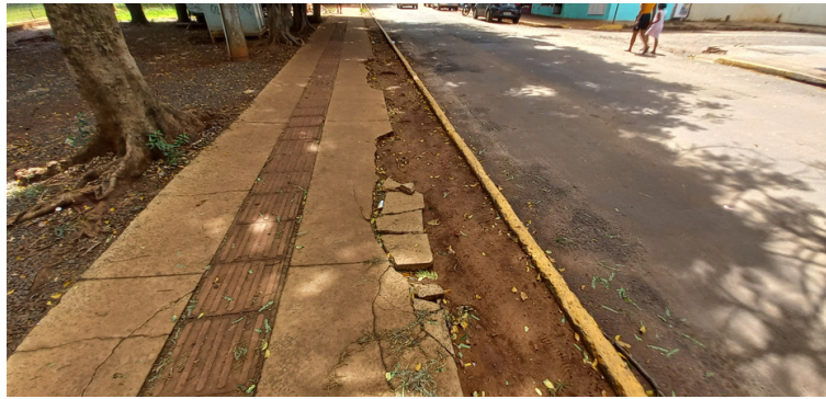
Foto 3 - Calçamento com o piso danificado.
