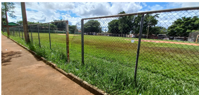
Foto 7 - Campo de futebol com alambrado avariado.
