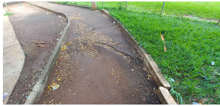
Foto 2 - Pista de caminhada com desniveis no pavimento.
