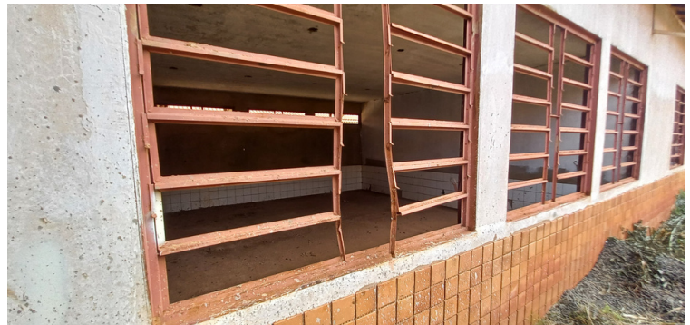
Foto 8 - Determinadas esquadrias sofreram tentativas de furto.
