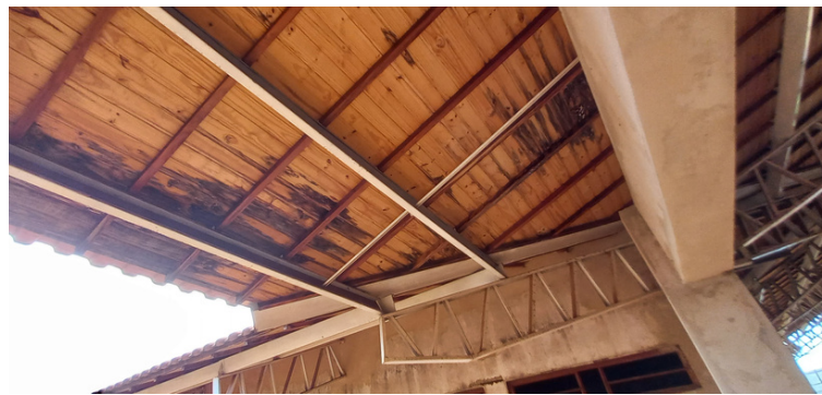
Foto 5 - Há pontos de infiltração pela obra.
