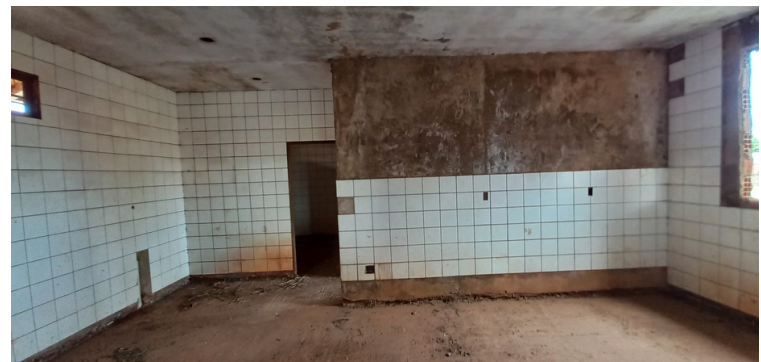
Foto 6 - A edificação apresenta bolor evidente.
