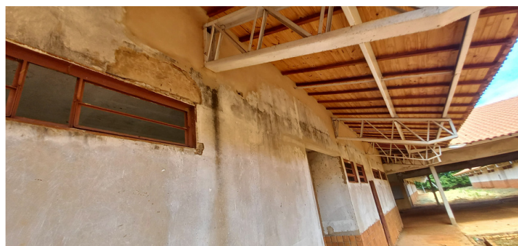
Foto 7 - As esquadrias estão enferrujadas.
