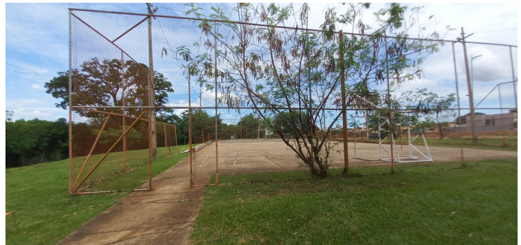
Foto 8 - Grade de proteção com avaria.
