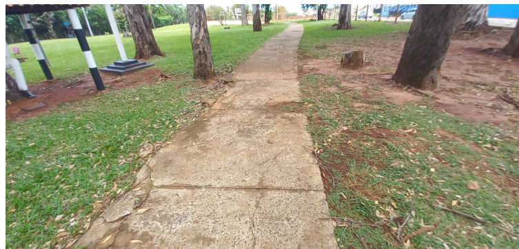
Foto 5 - Calçadas com pavimento com desníveis.
