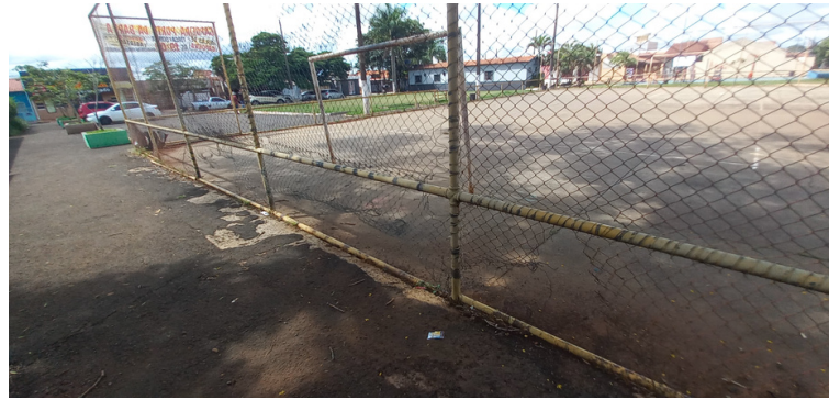
Foto 4 - Grade de proteção da quadra poliesportiva avariada.
