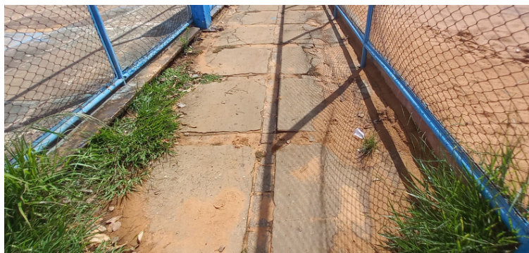
Foto 3 - Calçamento interno danificado, em locais pontuais.
