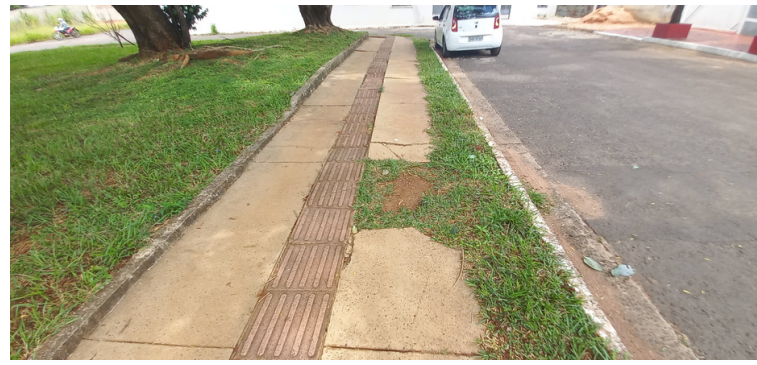
Foto 2 - Calçamento com desníveis.
