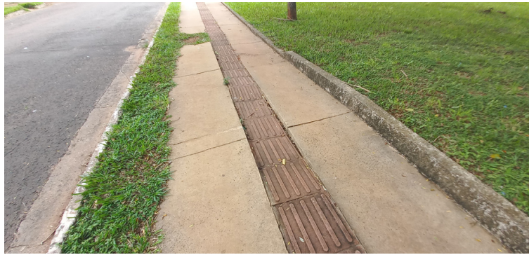
Foto 3 - Calçada com rachaduras.
