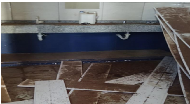
Foto 5 Banheiro abandonado, com placas do forro caídas.
