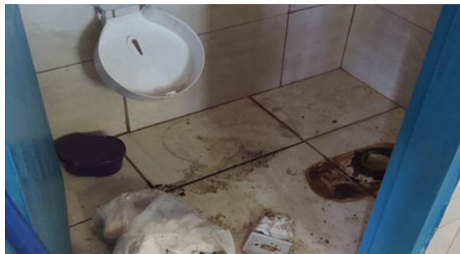
Foto 2 Banheiro depredado, sanitário furtado.
