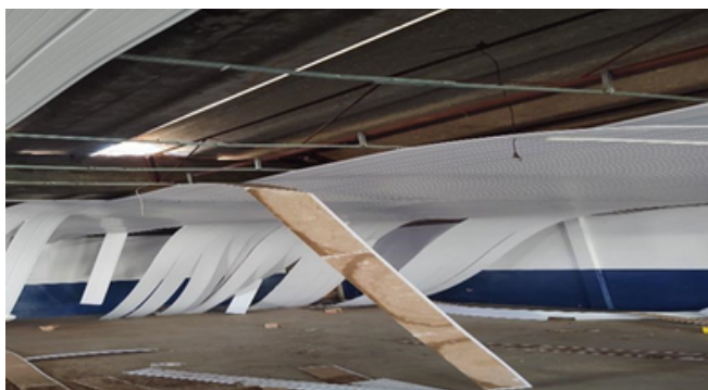
Foto 3 Estrutura interna com forro em PVC deteriorada.
