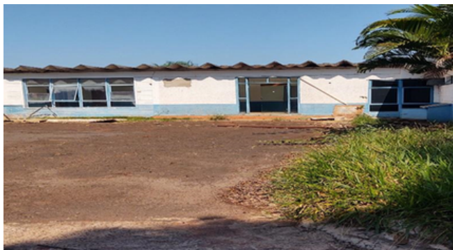
Foto 1 Entrada do prédio com bastante vegetação sem manutenção.
