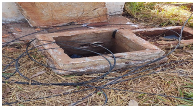
Foto 6 Caixa de energia com fios furtados.
